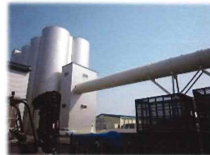
乾燥調整施設
